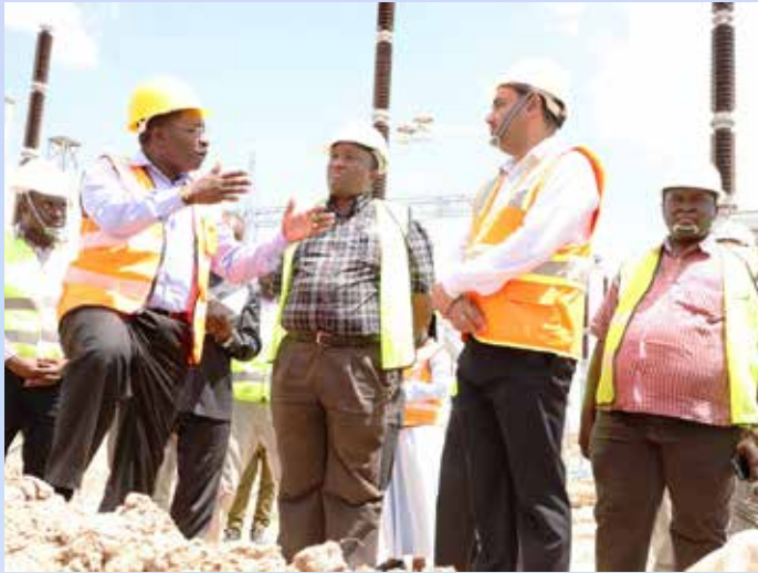
Waziri wa Nishati Dkt Medard Kalemmani (kushoto), akitoa maelekezo kwa mkandarasi (Kampuni ya KCE) anayetekeleza mradi wa upanuzi wa kituo cha kupoza umeme Zuzu, Dodoma, alipofanya ziara kukagua maendeleo ya mradi huo, Februari 19, 2020.
