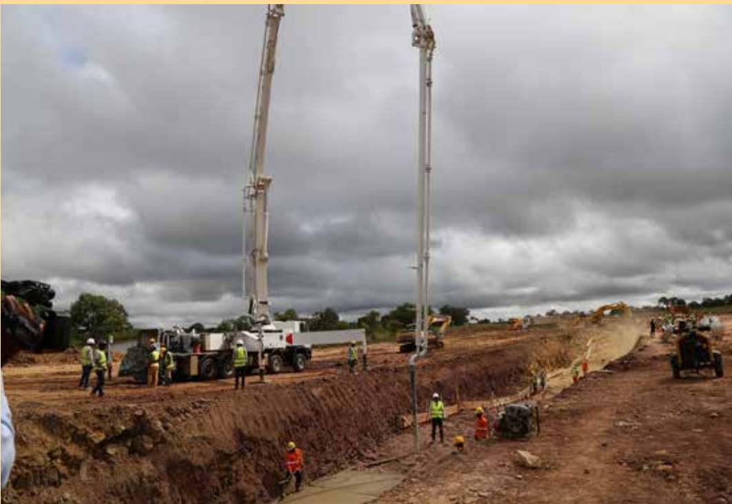
Mafundi wakiendelea na shughuli za ujenzi mradi wa kufua umeme kwa maji wa Julius Nyerere (JNHPP), Aprili 10, 2021.
