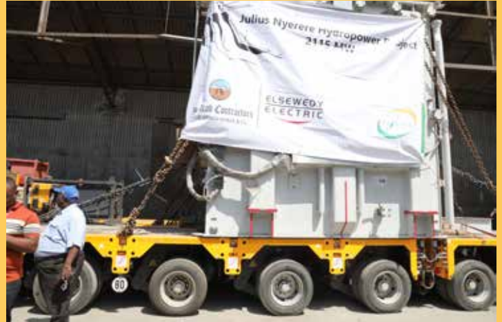
Transfoma ikiwa tayari imepakwa kwenye gari kwaajili ya kupelekwa katika mradi wa bwawa la kufua umeme wa maji la Julius Nyerere (JNHPP).
