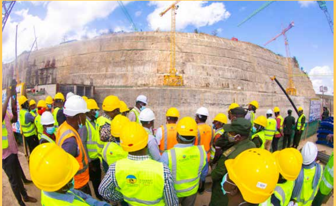
Kamati ya Uongozi ya Mradi wa Julius Nyerere (JNHPP), wakitazama eneo linalojengwa nyumba ya kuendesha mitambo ya kuzalisha umeme walipofanya ziara ya kukagua mradi huo, Julai 13, 2021.
