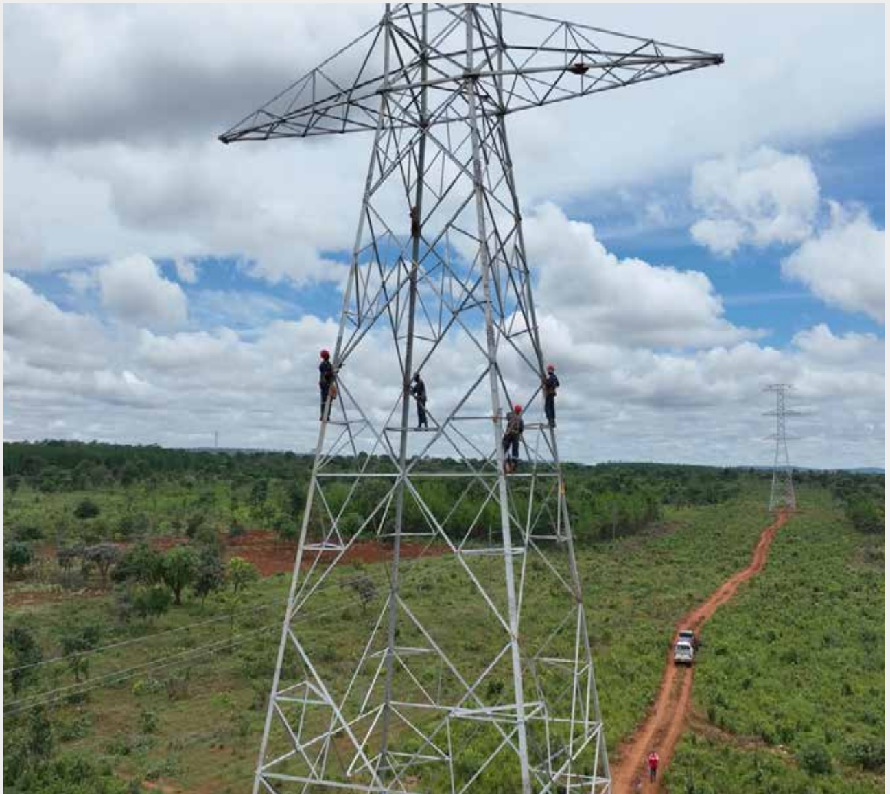
Ujenzi wa njia ya kusafirisha Umeme wa Msongo mkubwa wa kV 400 kutoka Nyakanazi hadi Kigoma.
